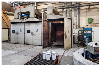
Fours de l'atelier d'imprégnation. Phot. Jérôme Mongreville IVR43_20162500156NUC4A
