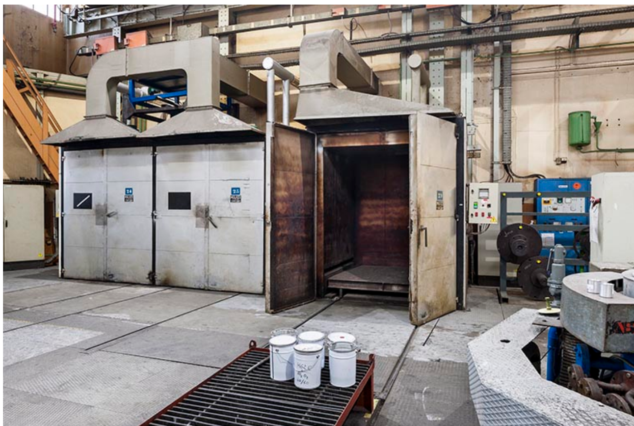
Fours de l'atelier d'imprégnation.
