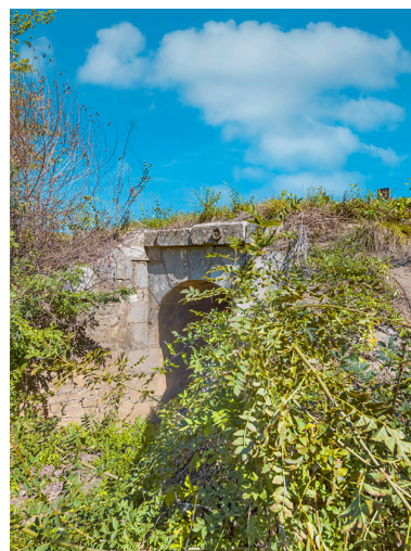
Le ponceau avec ses murs en aile, côté Saône. Phot. Thierry Kuntz IVR26_20197100515NUC4A
