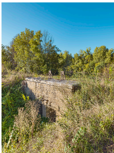
Le système de vannes. Phot. Thierry Kuntz IVR26_20197100514NUC4A
