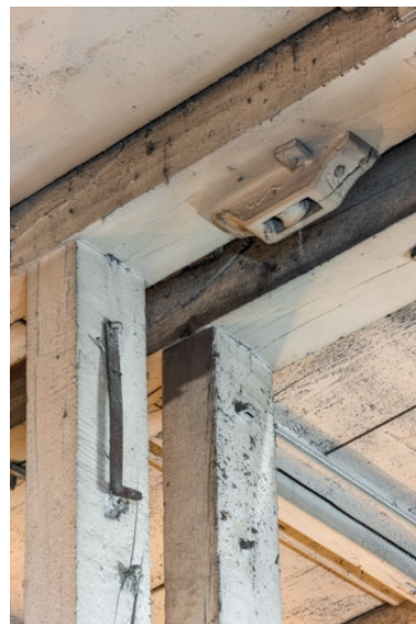
2e dessous : charpente soutenant le plancher du 1er dessous, au niveau d'une costière.
