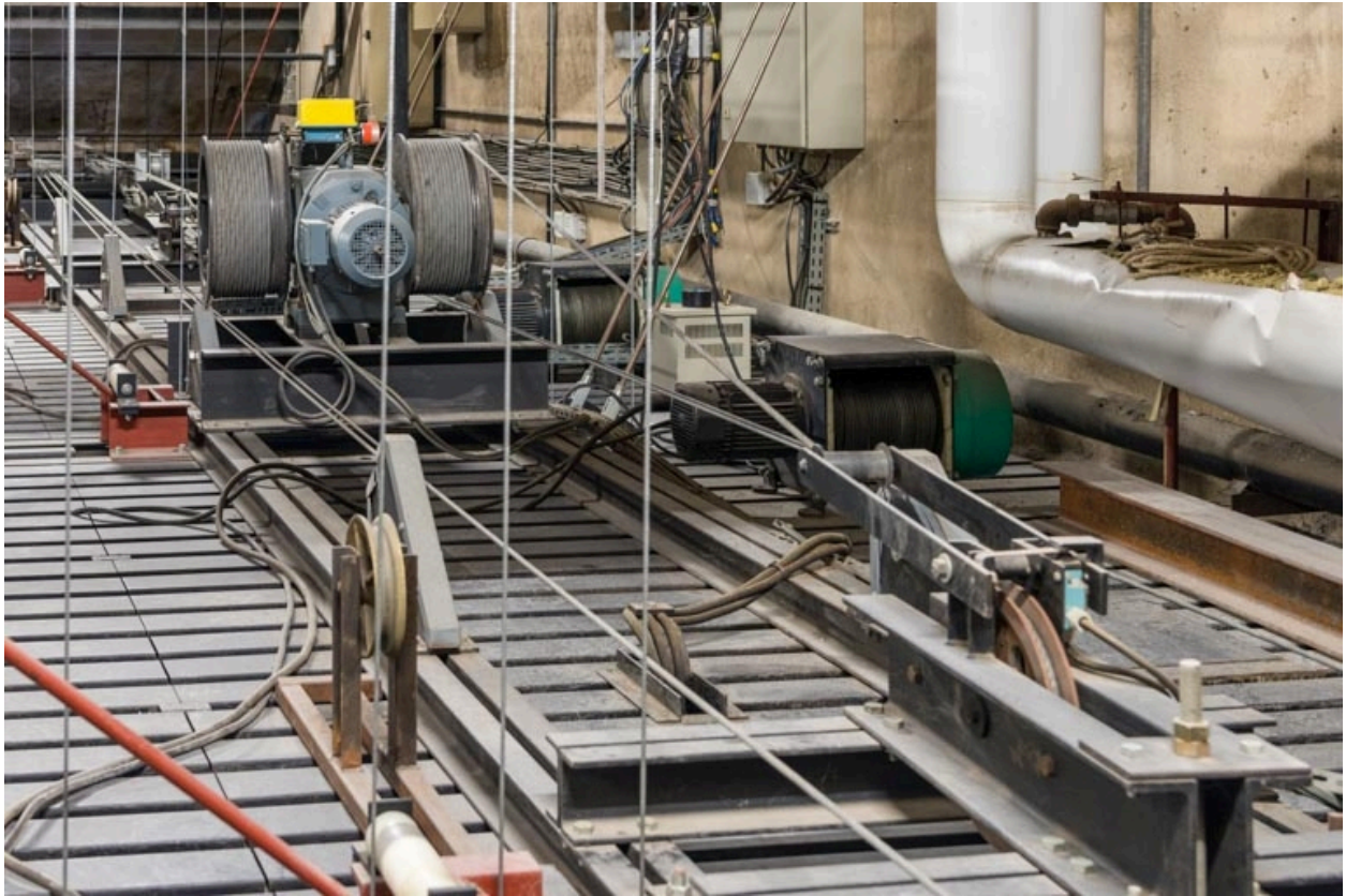
Cintre : moteur électrique d'une équipe (cadrage horizontal).
