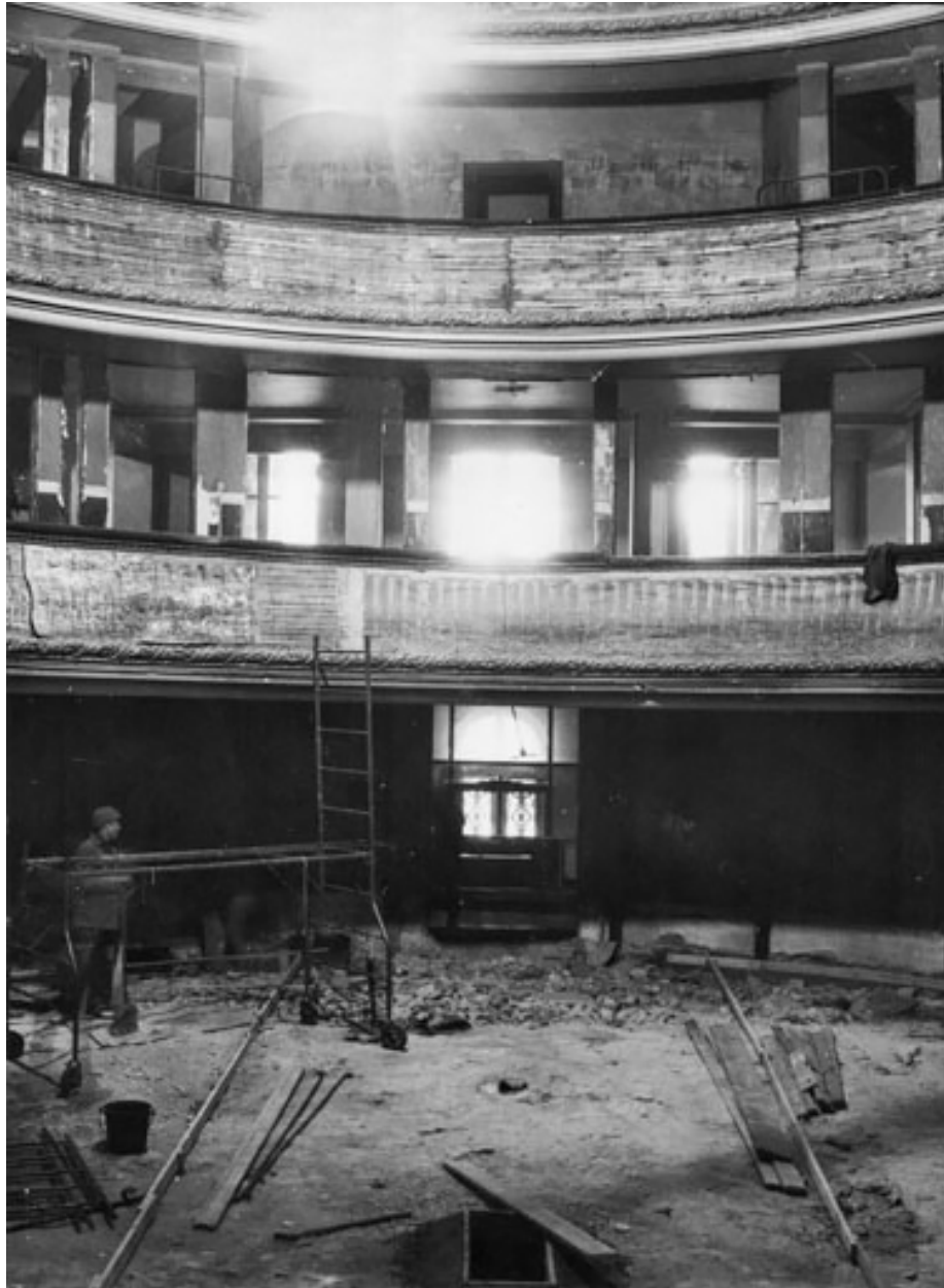
Elévations 1re et 2ème galeries face aux loges d'adjoint [lors des travaux]. S.d. [1970].
