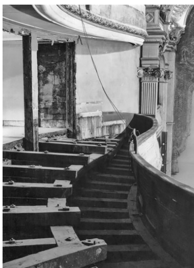
2ème galerie - ossature côté scène [pendant les travaux]. S.d. [1970]. Autr. auteur inconnu IVR26_20222100774NUC2
