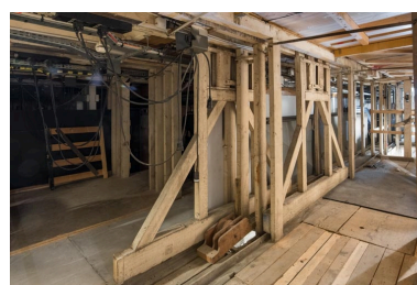
1er dessous : chariot de costière (chariot mobile permettant le déplacement des châssis du décor). Phot. Pierre-Marie Barbe-Richaud IVR26_20222100656NUC4A
