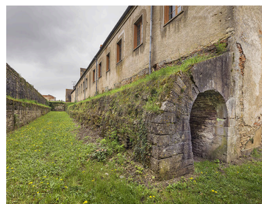
La galerie voûtée reliant la tour basse des Moulins au bastion de la tour Beauregard. Phot. Thierry Kuntz IVR26_20242100235NUC4A
