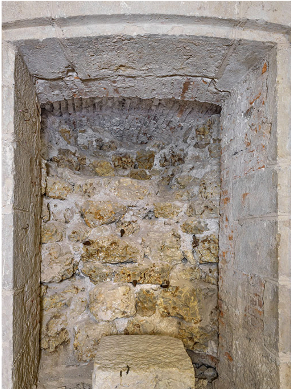
Tour Notre-Dame : ouverture obstruée.
