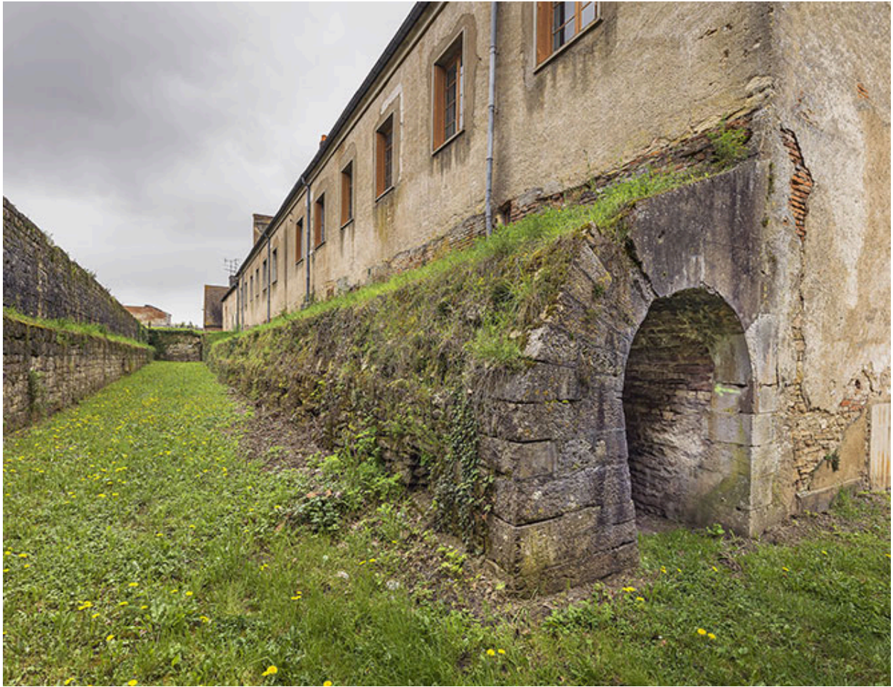
La galerie voûtée reliant la tour basse des Moulins au bastion de la tour Beauregard.
