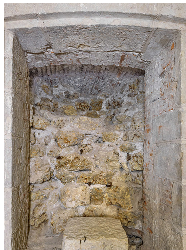
Tour Notre-Dame : ouverture obstruée. Phot. Thierry Kuntz IVR26_20242100248NUC4A
