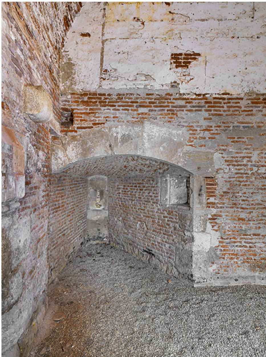
Pavillon d'entrée : poste de garde et de tir du corps de garde.
