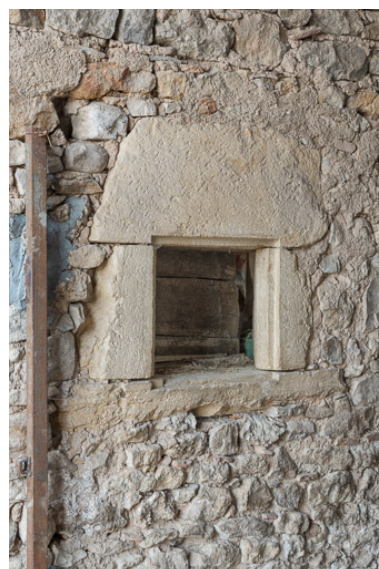
Feuron percé dans le mur entre la remise et l'étable Phot. Pierre-Marie Barbe-Richaud IVR26_20197100241NUC4A
