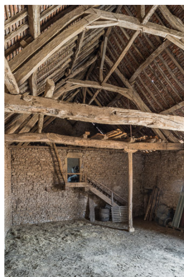
Vue intérieure du cuvage : escalier permettant l'accès à un grenier, situé dans le même bâtiment. Phot. Pierre-Marie Barbe-Richaud IVR26_20197100238NUC4A
