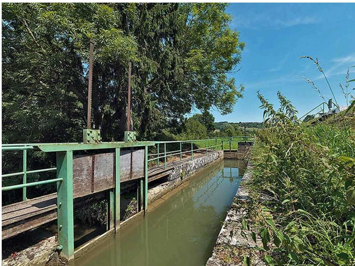
Vannes de régulation sur la rigole.
