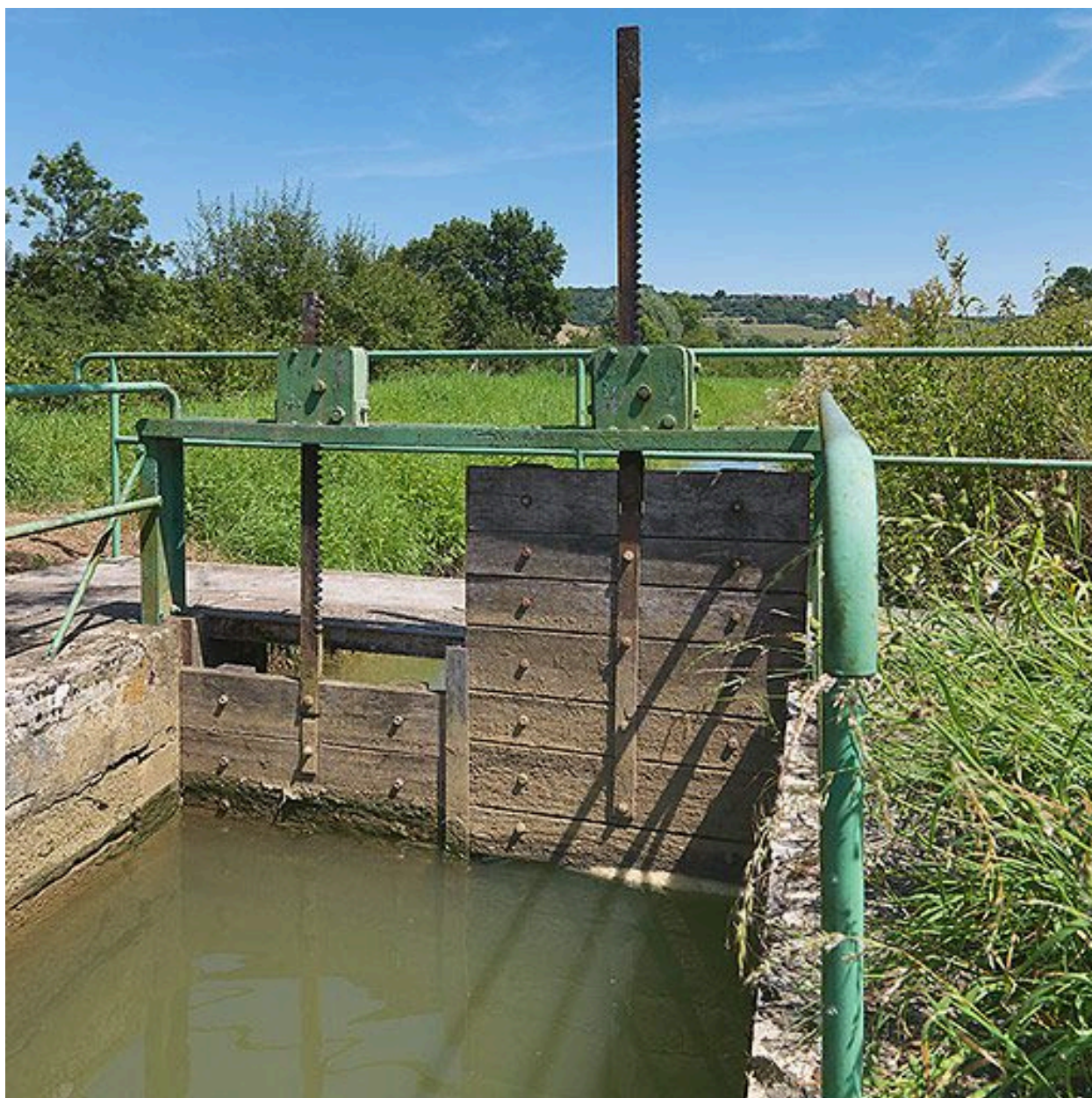
Vannes de régulation sur la rigole.
