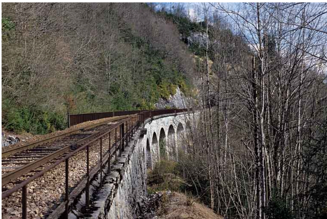
Viaduc de la Grande Roche : vue en enfilade, depuis le côté La Cluse (sud).
