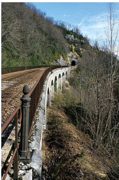
Viaduc de la Grande Roche et tunnel du Craपाud : vue d'ensemble, depuis le côté La Cluse (sud).
