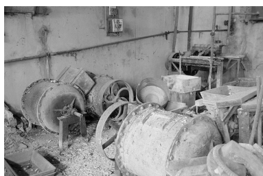
Moteurs électriques des équipes. Phot. Laurent Poupard IVR43_19913901137Z
