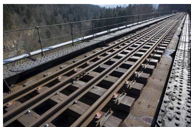
La voie sur la travée métallique, depuis le côté La Cluse. Phot. Yves Sancey IVR43_20073900065NUCA
