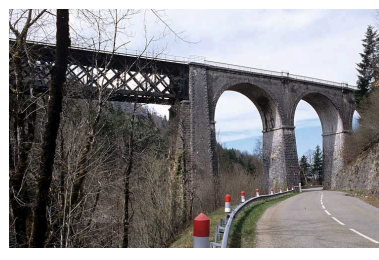
Partie en maçonnerie rive droite, depuis la route en amont. Phot. Yves Sancey IVR43_20053900083ZA
