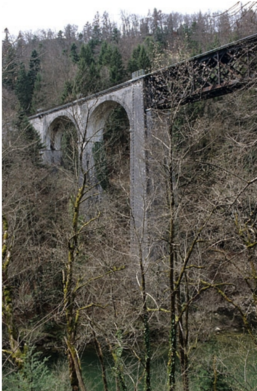
Partie en maçonnerie rive gauche et travée métallique, depuis la rive droite en amont.
