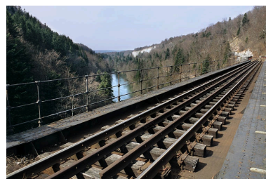
La voie sur la travée métallique, depuis le côté rive gauche (côté La Cluse). Phot. Yves Sancey IVR43_20053900107ZA
