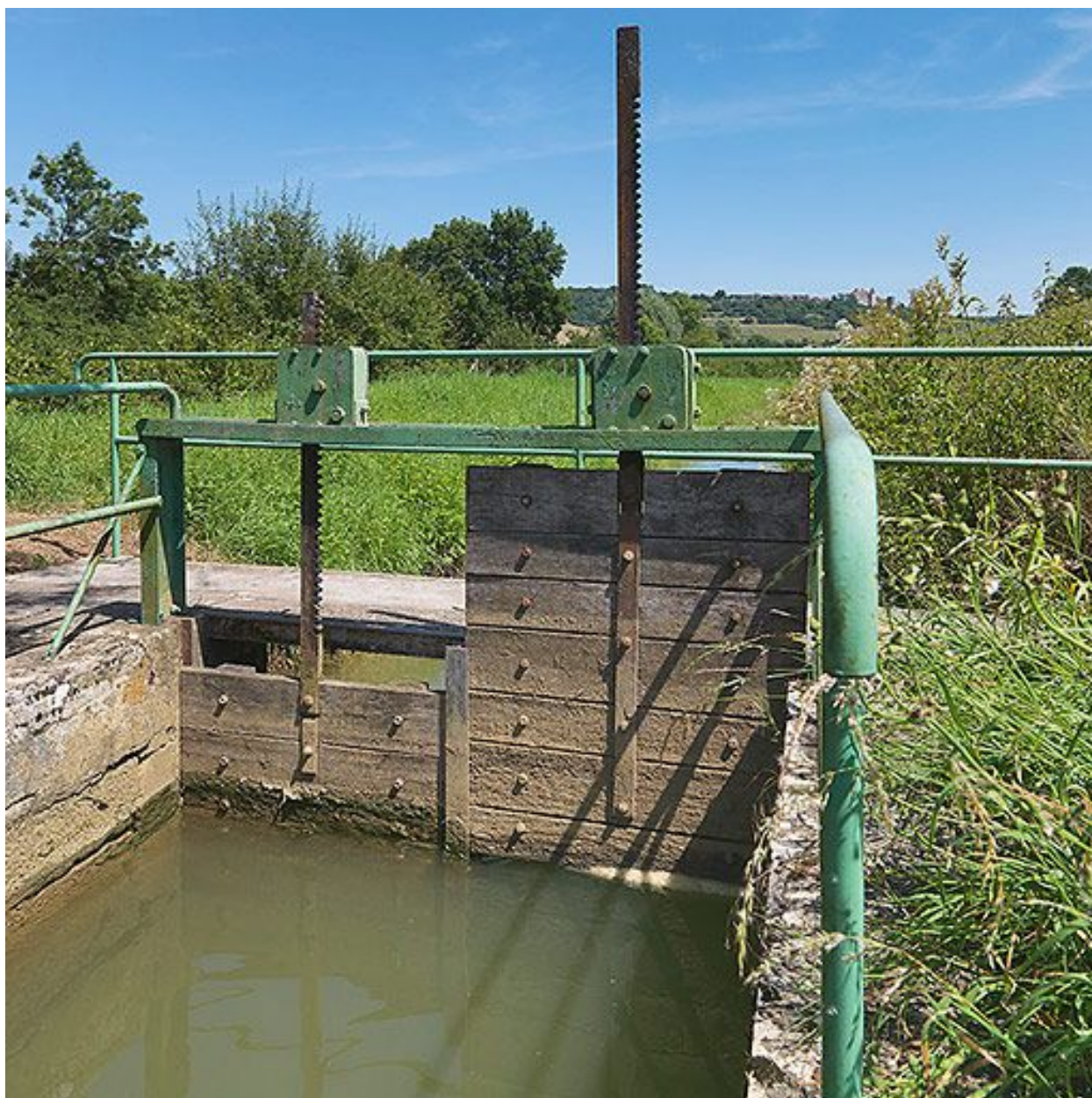
Vannes de régulation sur la rigole.
