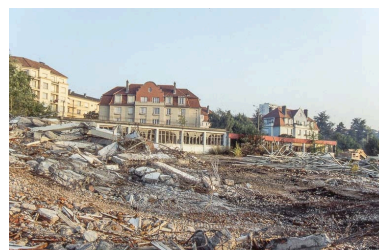
Destruction de l'usine, 25 août 1993 à midi : local syndical et réfectoire. Phot. Laurent Poupard IVR43_19932500188ZA
