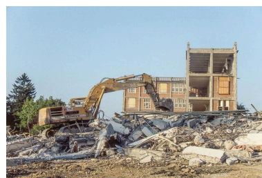
Destruction de l'usine, 20 août 1993 au matin : pelle mécanique et ateliers depuis le nord-est. Phot. Laurent Poupard IVR43_19932500162ZA
