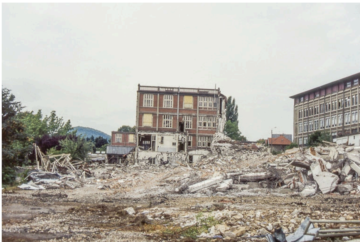
Destruction de l'usine, 22 août 1993 : atelier (6a) vu depuis le nord-est.
