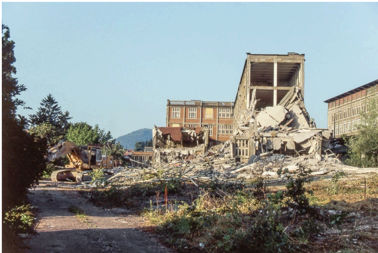
Destruction de l'usine, 18 août 1993 au matin : vue d'ensemble depuis le nord-est.
