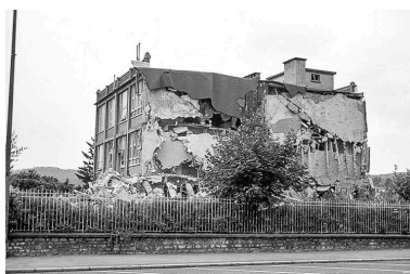
Destruction de l'usine, 22 août 1993 : ateliers (6a, 2a) vus depuis le nord. Phot. Laurent Poupard IVR43_19932500170Z
