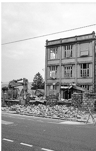
Destruction de l'usine, 23 août 1993 : pelle mécanique et atelier (2a) depuis l'ouest. Phot. Laurent Poupard IVR43_19932500178Z
