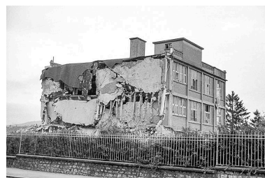
Destruction de l'usine, 22 août 1993 : ateliers (6a, 2a) vus depuis l'ouest. Phot. Laurent Poupard IVR43_19932500172Z
