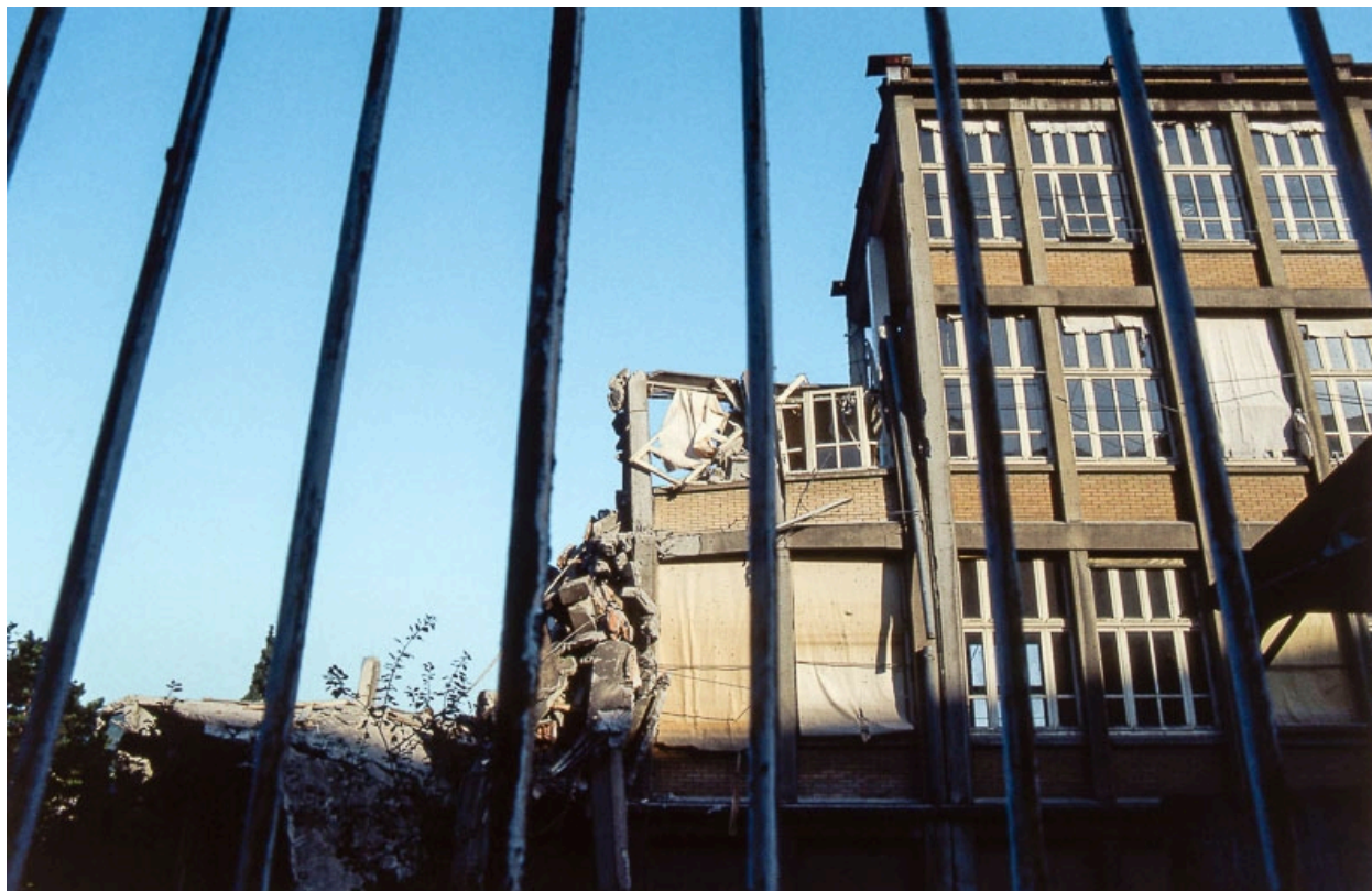
Destruction de l'usine : façade sur l'avenue Villarceau vue au travers de grilles.
