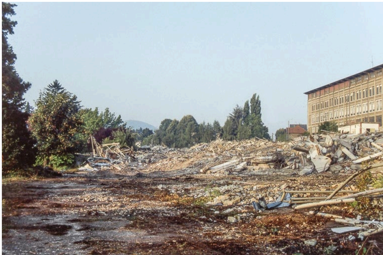
Destruction de l'usine, 25 août 1993 à midi : vue d'ensemble depuis le nord-est.
