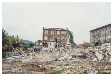
Destruction de l'usine, 22 août 1993 : atelier (6a) vu depuis le nord-est. Phot. Laurent Poupard IVR43_19932500174ZA
