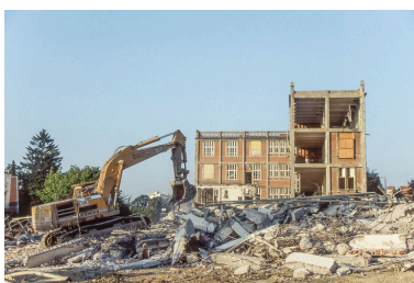
Destruction de l'usine, 20 août 1993 au matin : pelle mécanique et ateliers depuis le nord-est. Phot. Laurent Poupard IVR43_19932500161ZA
