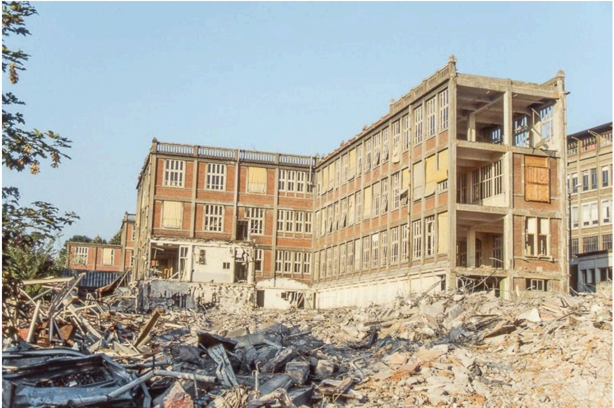
Destruction de l'usine, 20 août 1993 au matin : ateliers (6) depuis le nord-est.
