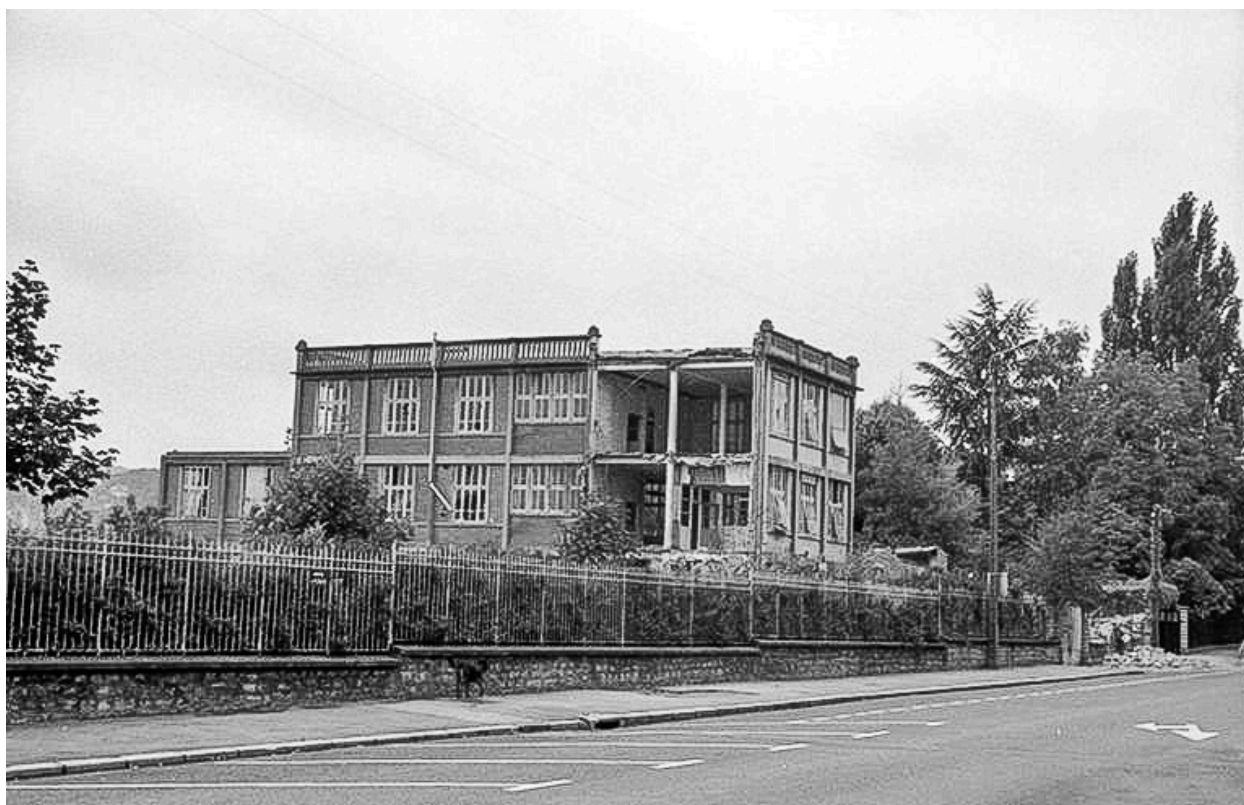
Destruction de l'usine, 23 août 1993 : atelier (2a) vu depuis le nord.
