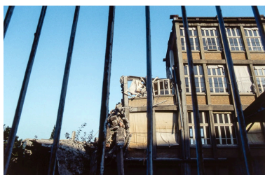
Destruction de l'usine : façade sur l'avenue Villarceau vue au travers de grilles. Phot. Laurent Poupard IVR43_19932500189ZA
