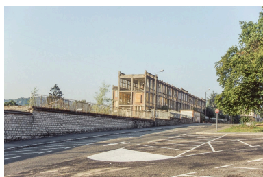
Destruction de l'usine, 20 août 1993 au matin : façade sur l'avenue Villarceau depuis le nord. Phot. Laurent Poupard IVR43_19932500164ZA
