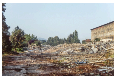
Destruction de l'usine, 25 août 1993 à midi : vue d'ensemble depuis le nord-est. Phot. Laurent Poupard IVR43_19932500186ZA
