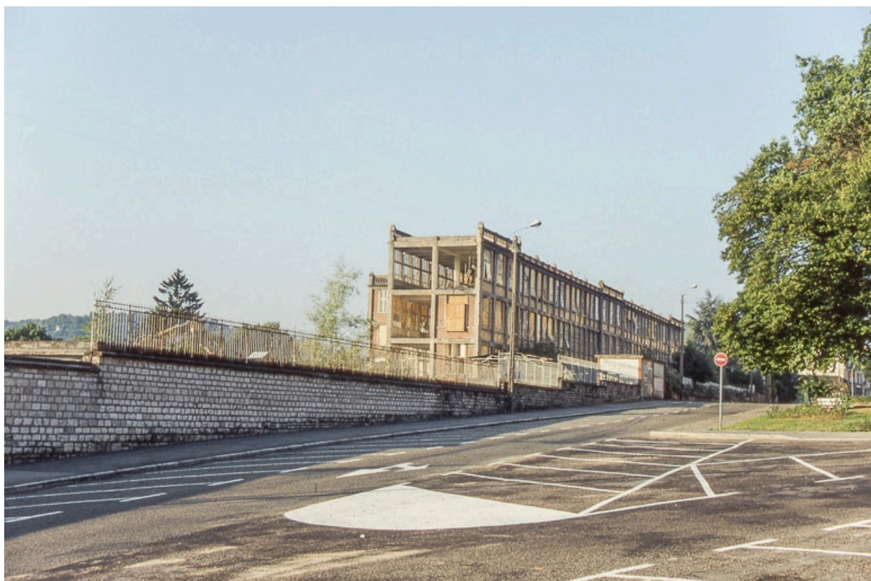
Destruction de l'usine, 20 août 1993 au matin : façade sur l'avenue Villarceau depuis le nord.
