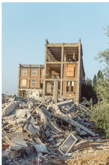
Destruction de l'usine, 20 août 1993 au matin : ateliers (6) puis le nord. Phot. Laurent Poupard IVR43_19932500159ZA
