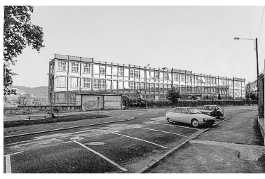
Destruction de l'usine, 22 août 1993 : atelier (6a) vu depuis le nord-est. Phot. Laurent Poupard IVR43_19932500173Z
