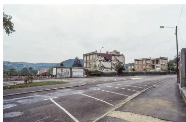
Destruction de l'usine, 22 août 1993 : ateliers (6a, 2a, 2c) vus depuis le nord. Phot. Laurent Poupard IVR43_19932500168ZA
