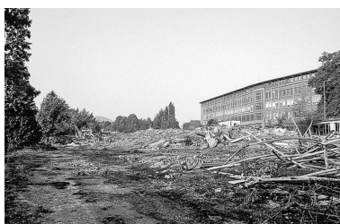
Destruction de l'usine, 25 août 1993 à midi : vue d'ensemble depuis le nord-est. Phot. Laurent Poupard IVR43_19932500184Z
