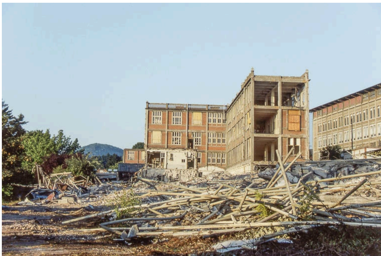
Destruction de l'usine, 20 août 1993 au matin : ateliers depuis le nord-est.
