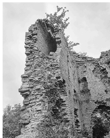
Vue intérieure du donjon montrant le passage à l'intérieur du mur. Phot. Yves Sancey IVR43_19833900756X
