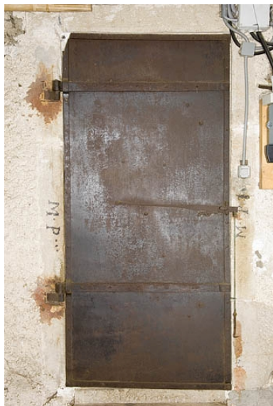
Porte coupe-feu fermée. Phot. Jérôme Mongreville IVR43_20092500093NUC2A
