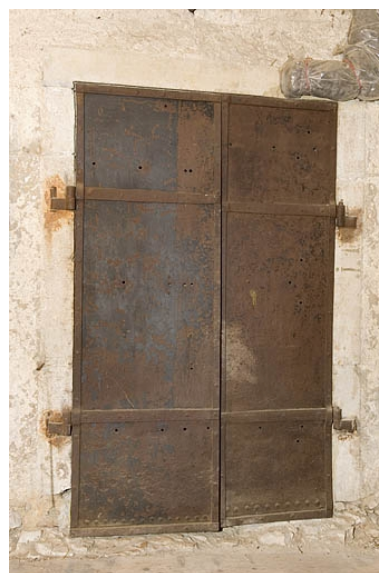
Porte coupe-feu à deux vantaux, fermée. Phot. Jérôme Mongreville IVR43_20092500095NUC2A
