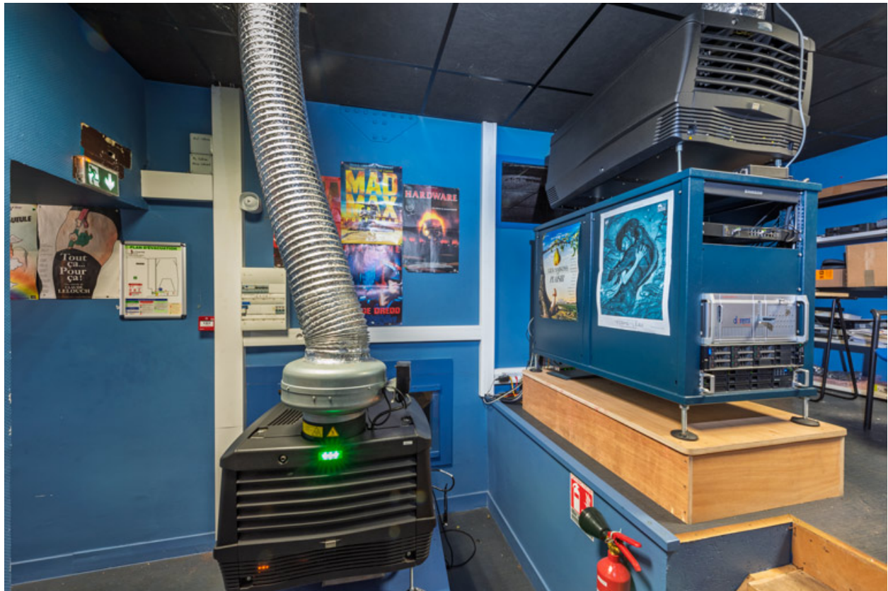
Cabine de projection : projecteurs Barco DP2K12C.
