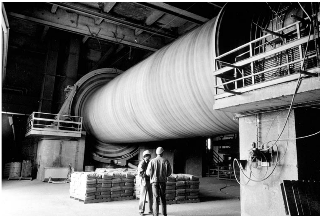
Atelier de fabrication : broyeur de clinkers.
