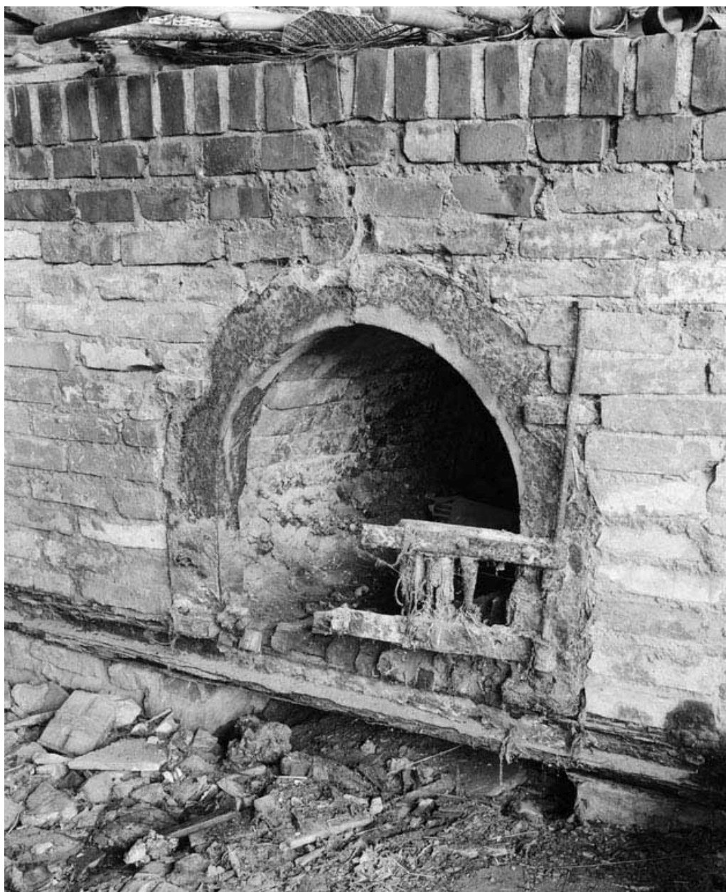
Détail du four : bouche d'enfournement du bois.
