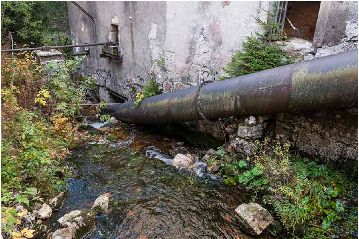
Conduite forcée de la turbine.
