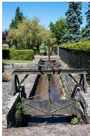
Vanne située en aval sud de la remise de matériel d'incendie, à l'entrée du village. Phot. Jérôme Mongreville IVR43_20177000826NUC4A
