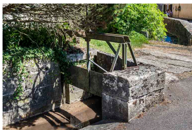
Vanne située à l'angle de l'impasse du château. Phot. Jérôme Mongreville IVR43_20177000829NUC4A
