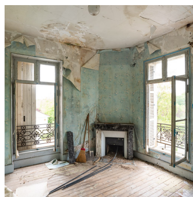
Chambre au premier étage avec deux fenêtres et une cheminée dans l'angle. Phot. Pierre-Marie Barbe-Richaud IVR26_20205800437NUC4A
