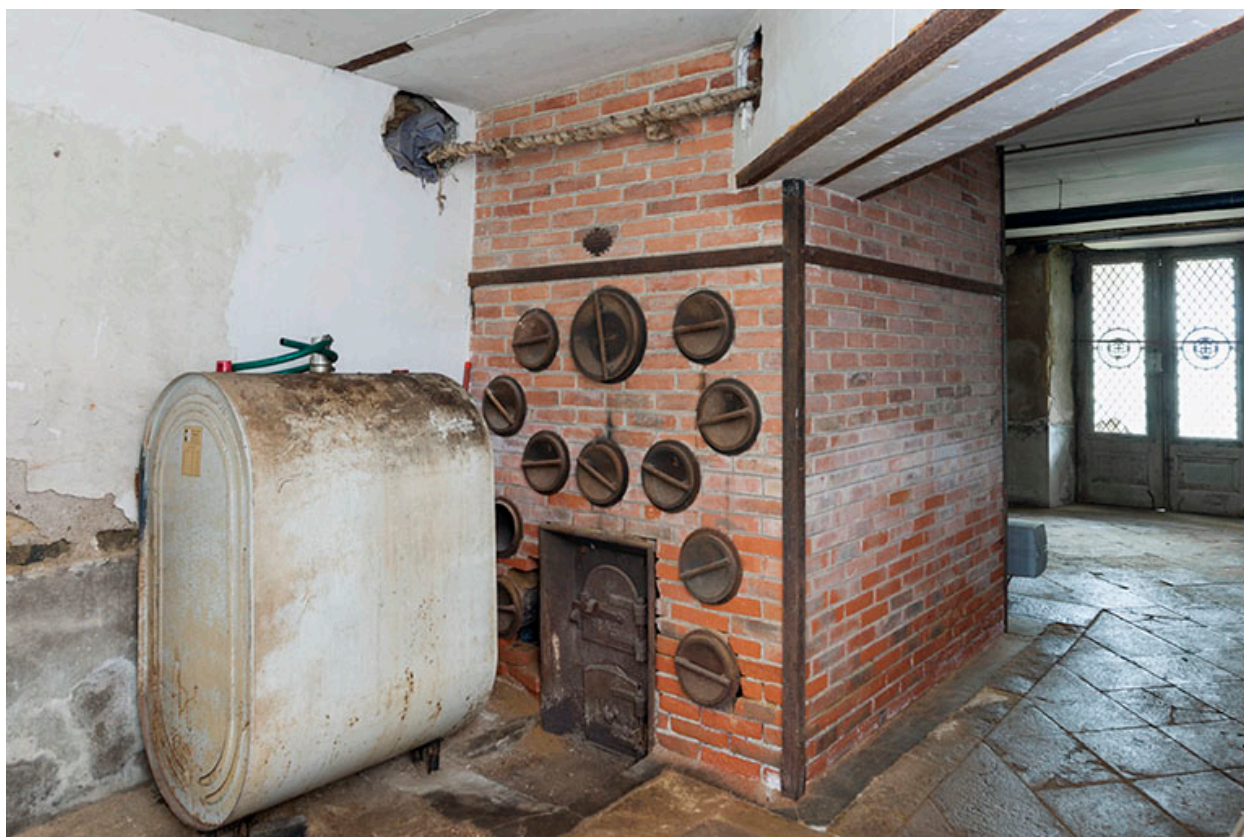
L'ancien chauffage centrale du château.
