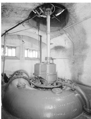
Turbine Neyret Beylier et Picard Pictet. Phot. Jérôme Mongreville IVR43_19923900522V
