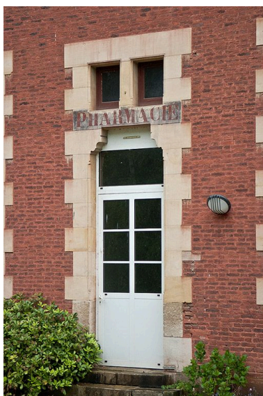
Pavillon de l'aile gauche : porte de l'ancienne pharmacie. Phot. Pierre-Marie Barbe-Richaud IVR26_20107100786NUC2A
