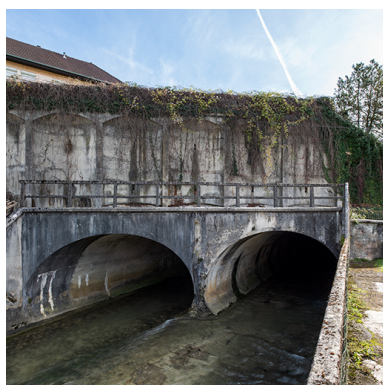
Canalisations de sortie. Phot. Nicolas Waltefaugle IVR43_20253900170NUC4A
