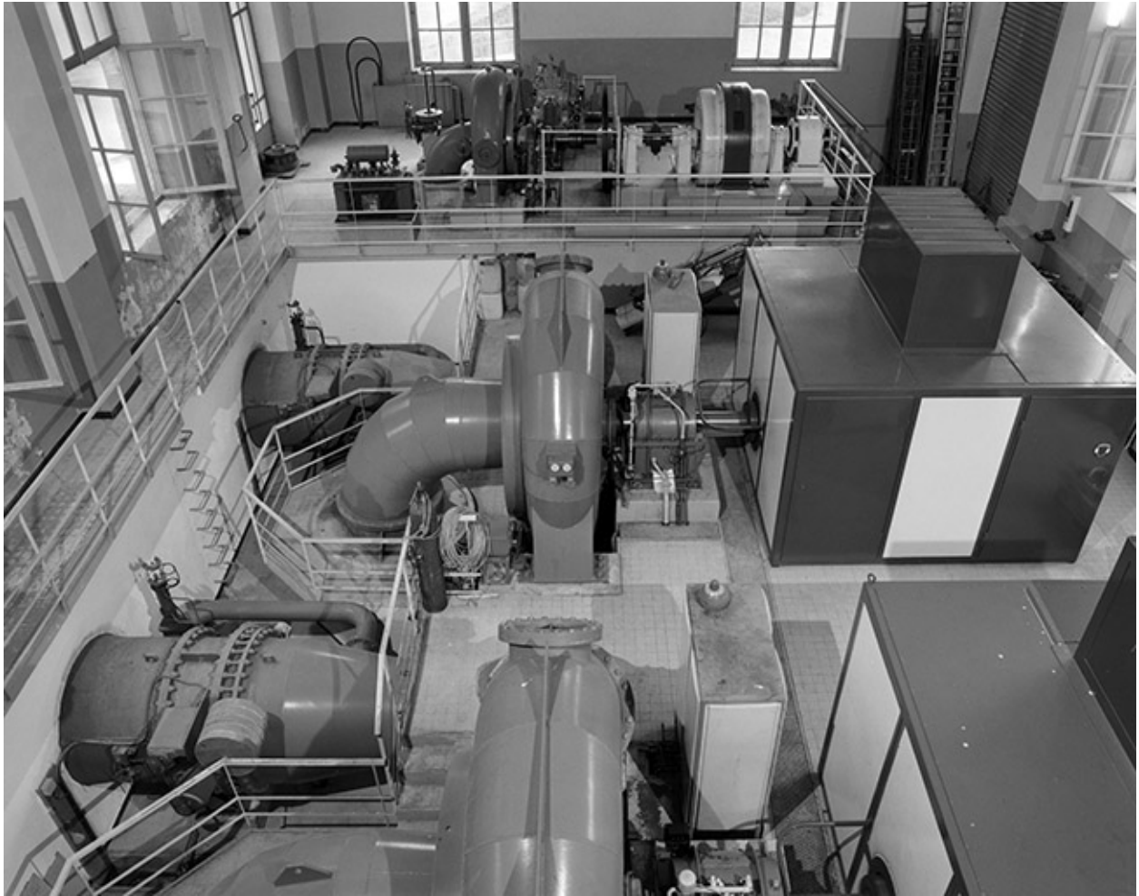
Intérieur de la centrale.
