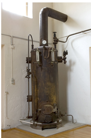
Salle de distillation. Chaudière Thiébaud (Tréviillers). Phot. Jérôme Mongreville IVR43_20067000799NUCA
