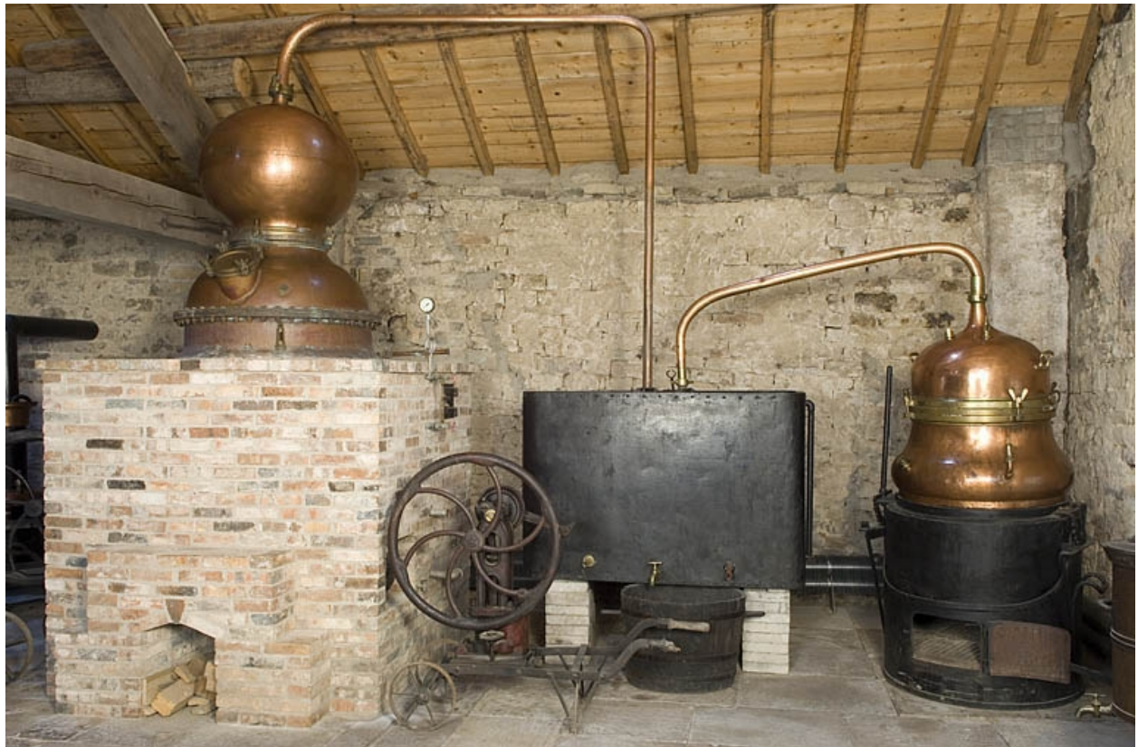
Alambics, chaudières et réfrigérant (au centre).
