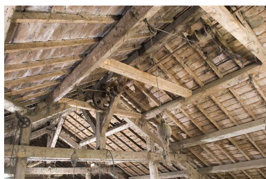
Grange haute : poulies et contreponds de la déchargeuse dans la charpente. Phot. Jérôme Mongreville IVR43_20082501113NUC2A
