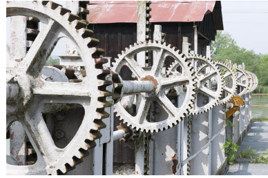
Vannage du barrage. Détail des engrenages. Phot. Jérôme Mongreville IVR43_20122501096NUC4A
