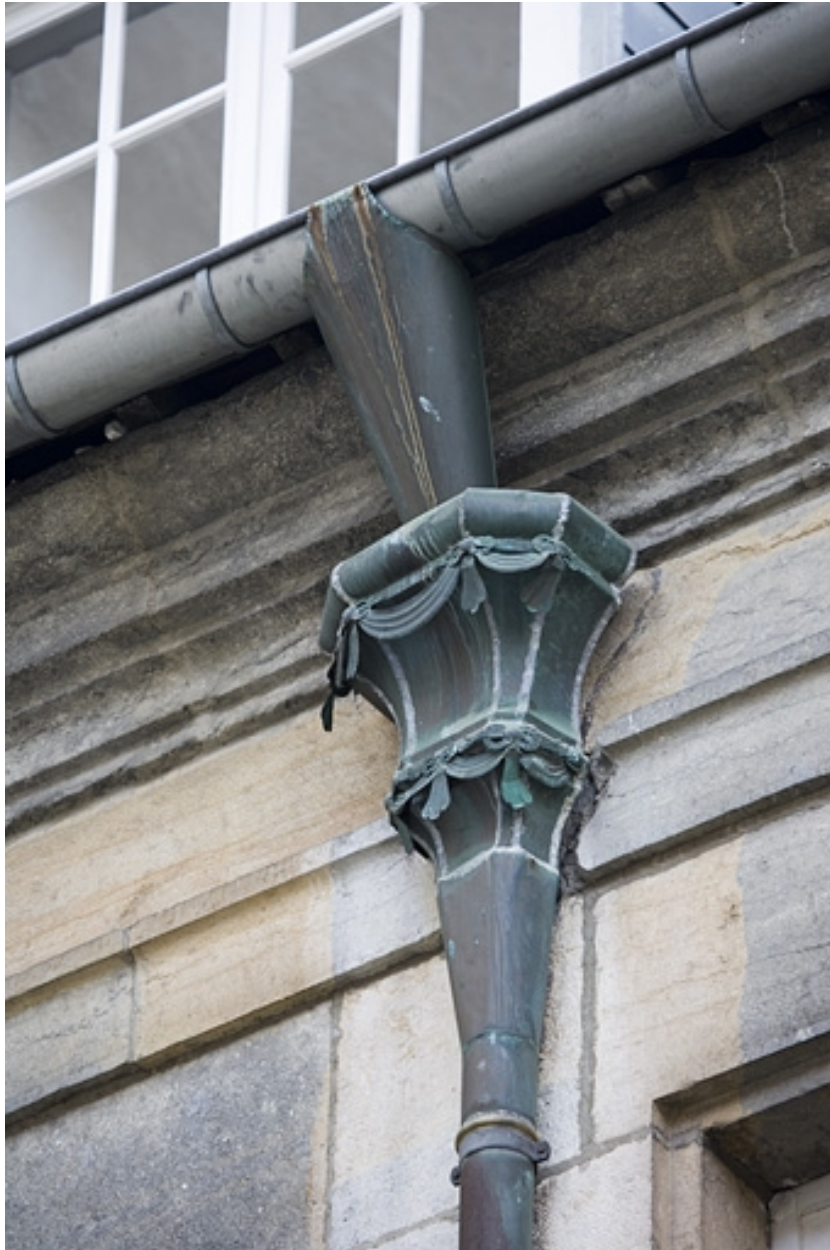
Détail d'une cuvette de descente des eaux sur la façade postérieure du logis principal.
