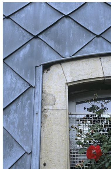
Bâtiment des voyageurs : détail de l'essentage de tôle de l'élévation latérale sud. Phot. Yves Sancey IVR43_20043900221ZA
