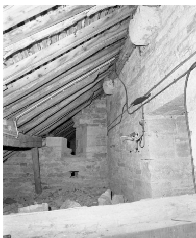
Mur gauche du clocher et mur postérieur de la chapelle gauche, vue prise du comble. Phot. Michel Rosso IVR26_20037101576X
