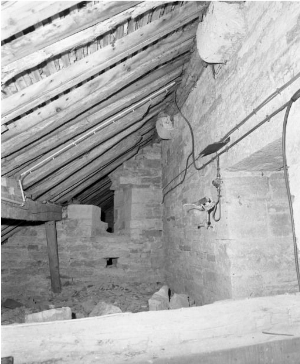
Mur gauche du clocher et mur postérieur de la chapelle gauche, vue prise du comble.
