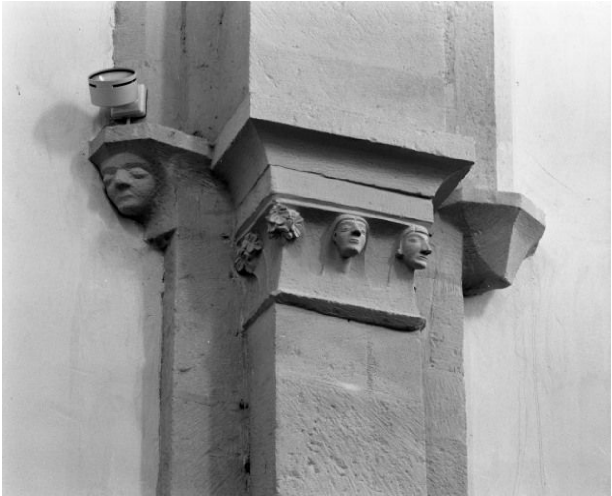
Nef, culots et chapiteau à droite entre les 1ère et 2e travées (n° 9 sur le plan de localisation).
