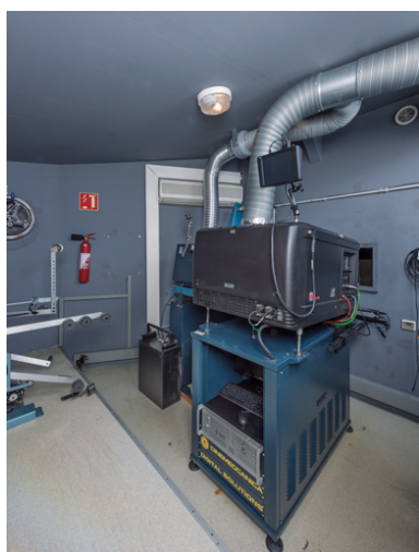
Cabine de la salle 1. Projecteurs numérique Barco (à droite) et argentique Cinemeccanica. Phot. Pierre-Marie Barbe-Richaud IVR26_20257100185NUC4A
