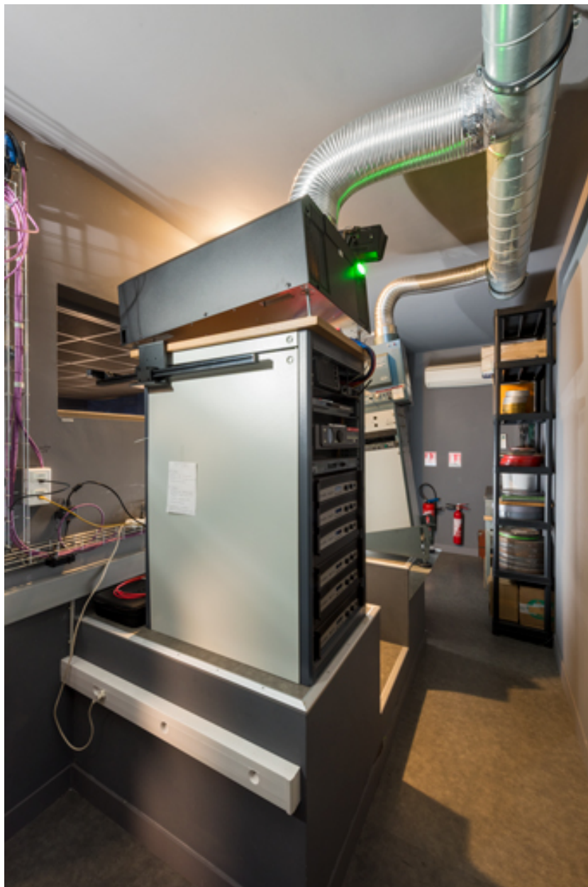
Cabine de la salle 4. Projecteurs numérique Barco (à gauche) et argentique Hortson.
