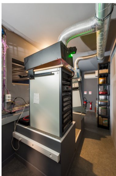
Cabine de la salle 4. Projecteurs numérique Barco (à gauche) et argentique Hortson. Phot. Pierre-Marie Barbe-Richaud IVR26_20257100176NUC4A
