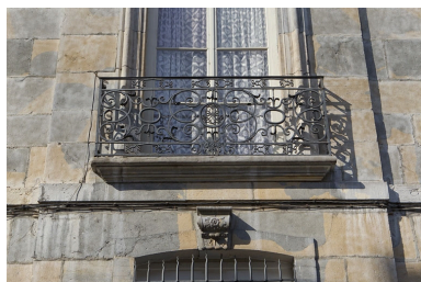
Aile droite : détail d'un garde- corps d'une fenêtre du premier étage. Phot. Yves Sancey IVR43_20102501018NUC2A
