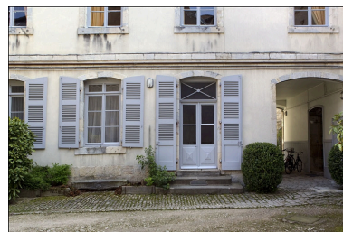
Détail du rez-de-chaussée de l'aile gauche du logis secondaire. Phot. Yves Sancey IVR43_20102500445NUC2A
