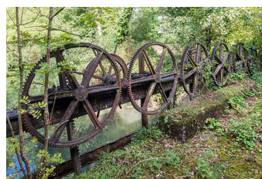
Mécanisme de levage du vannage. Phot. Jérôme Mongreville IVR43_20172501082NUC4A
