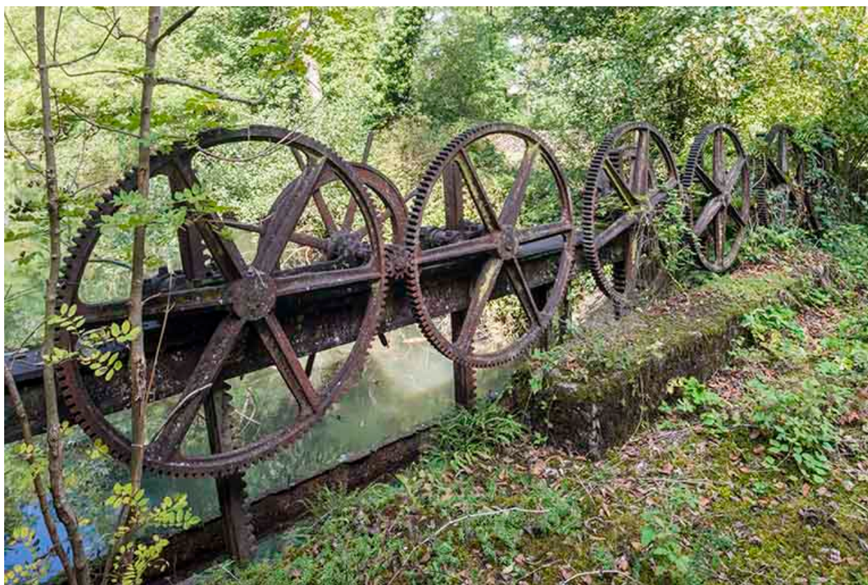
Mécanisme de levage du vannage.
