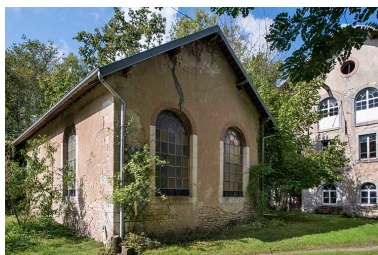
Salle de la machine à vapeur. Phot. Jérôme Mongreville IVR43_20172501076NUC4A
