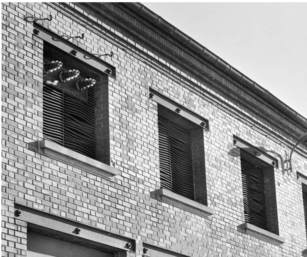
Transformateur : détail des baies supérieures.
