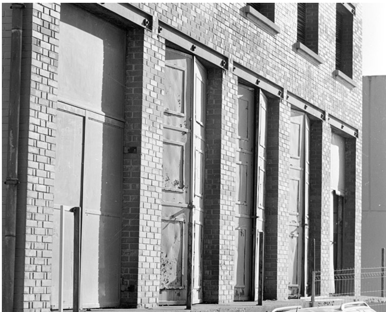
Transformateur : niveau des portes métalliques de la façade ouest.
