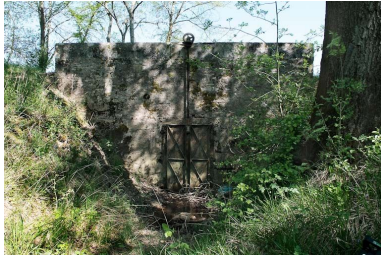
Vanne de l'aqueduc. Phot. Jean-Luc Duthu IVR26_20107100520NUC2A
