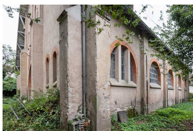
Mur-pignon nord et mur- gouttereau ouest, angle à contreforts. Phot. Jérôme Mongreville IVR43_20207000649NUC4A
