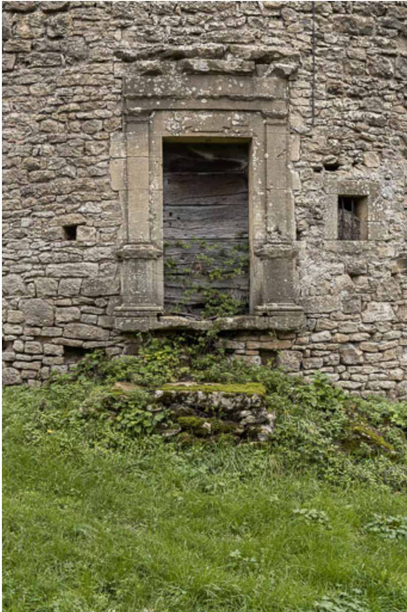
Porte de la tour avec pilastres et entablement, donnant accès à un escalier en vis
