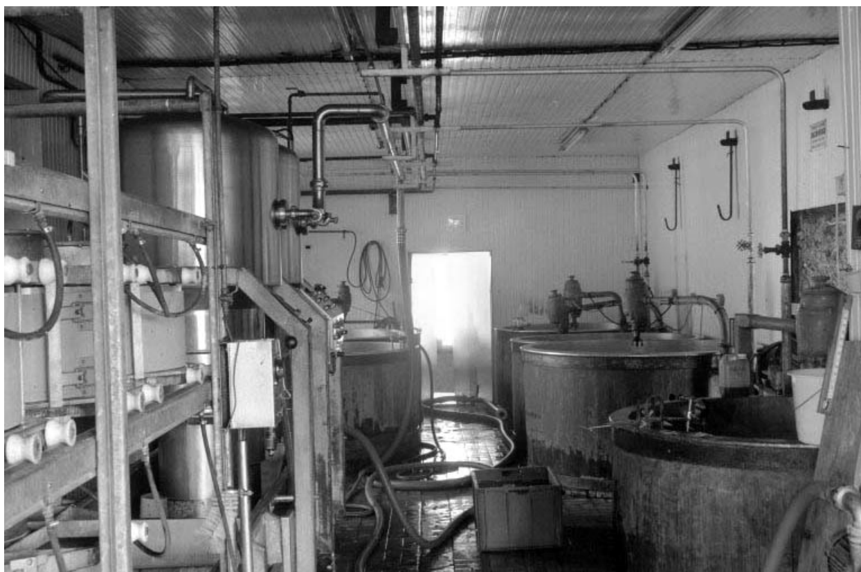
Intérieur de l'atelier de fabrication.
