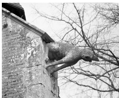
Gargouille sur le contrefort antérieur du chœur.
