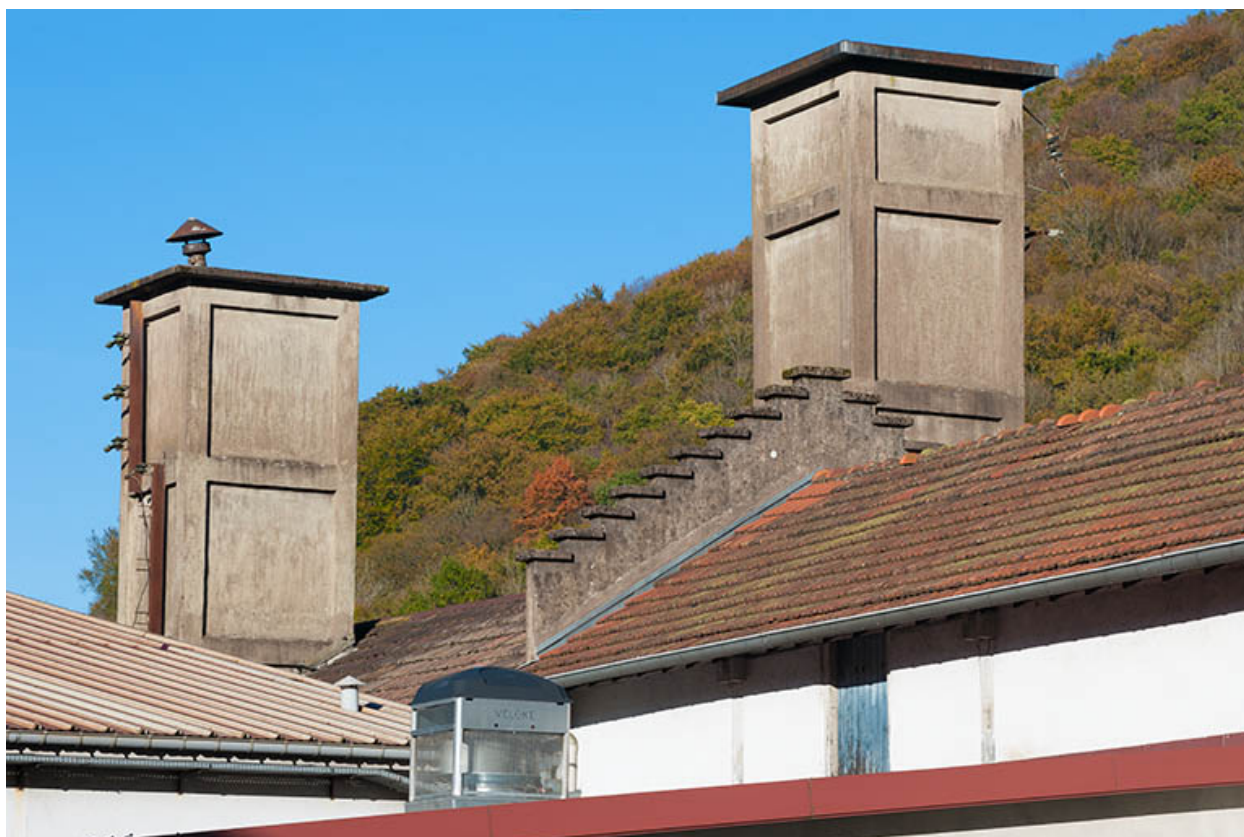
Anciens transformateurs électriques.
