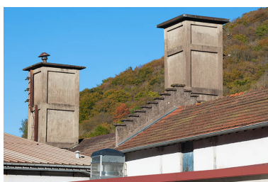
Anciens transformateurs électriques. Phot. Jérôme Mongreville IVR43_20142501613NUC4A
