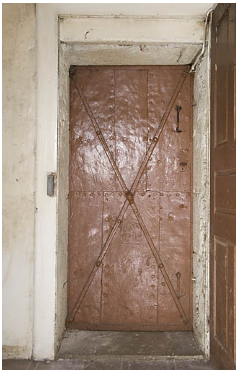
Appartement du 2nd étage : porte coupe-feu.
