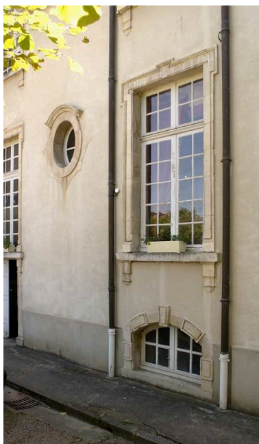
Ancien hôtel du gouverneur : élévation antérieure, porte d'entrée principale et fenêtres. Phot. Michel Thierry IVR26_20042100544NUC2A
