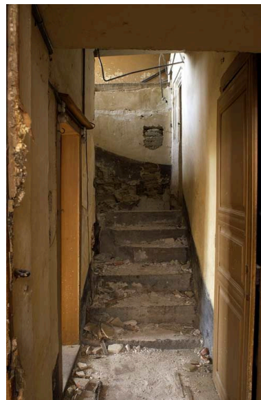
Ancien hôtel du gouverneur : passage donnant accès au laboratoire (porte à gauche) et à un escalier en ruine. Phot. Michel Thierry IVR26_20042100589NUC2A
