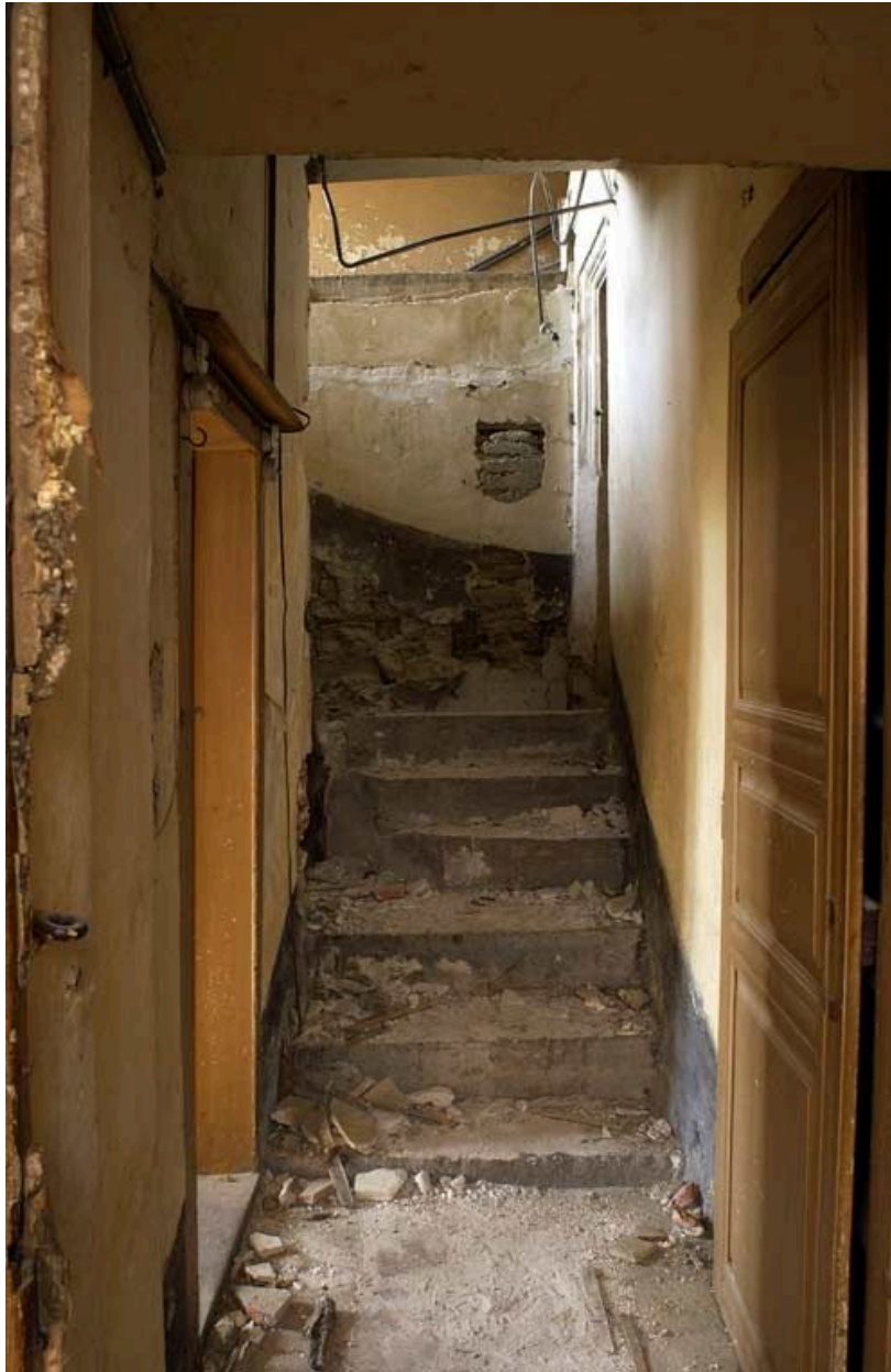
Ancien hôtel du gouverneur : passage donnant accès au laboratoire (porte à gauche) et à un escalier en ruine.
