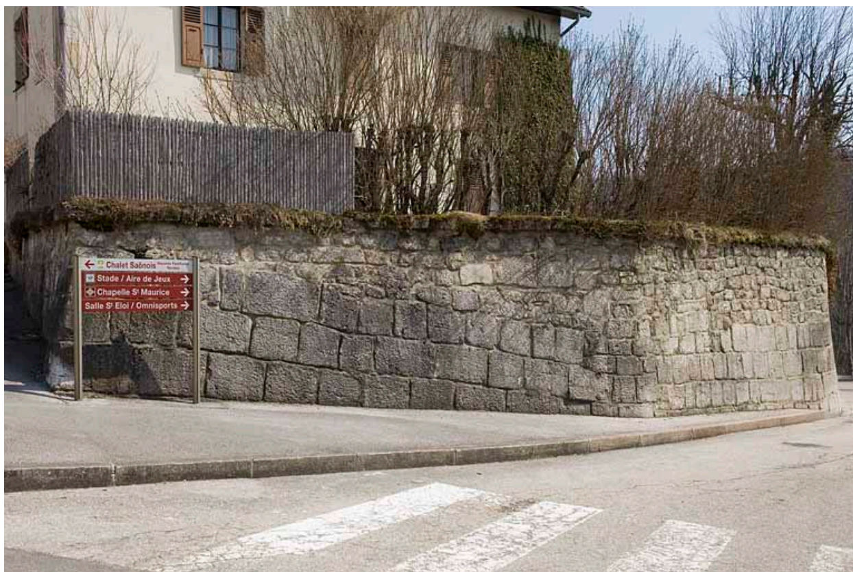
Enceinte au niveau de la maison Billet.
