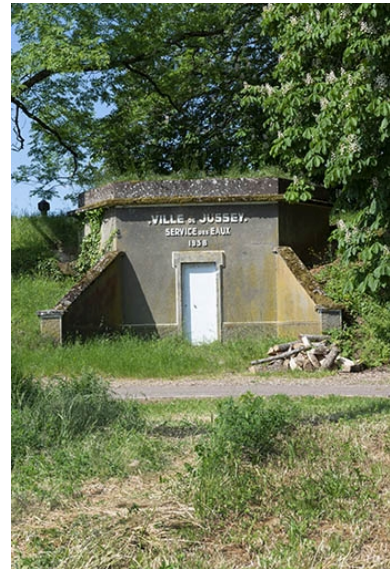
Le château d'eau de la Lanterne, vu de face. Phot. Jérôme Mongreville IVR43_20217000311NUC4A
