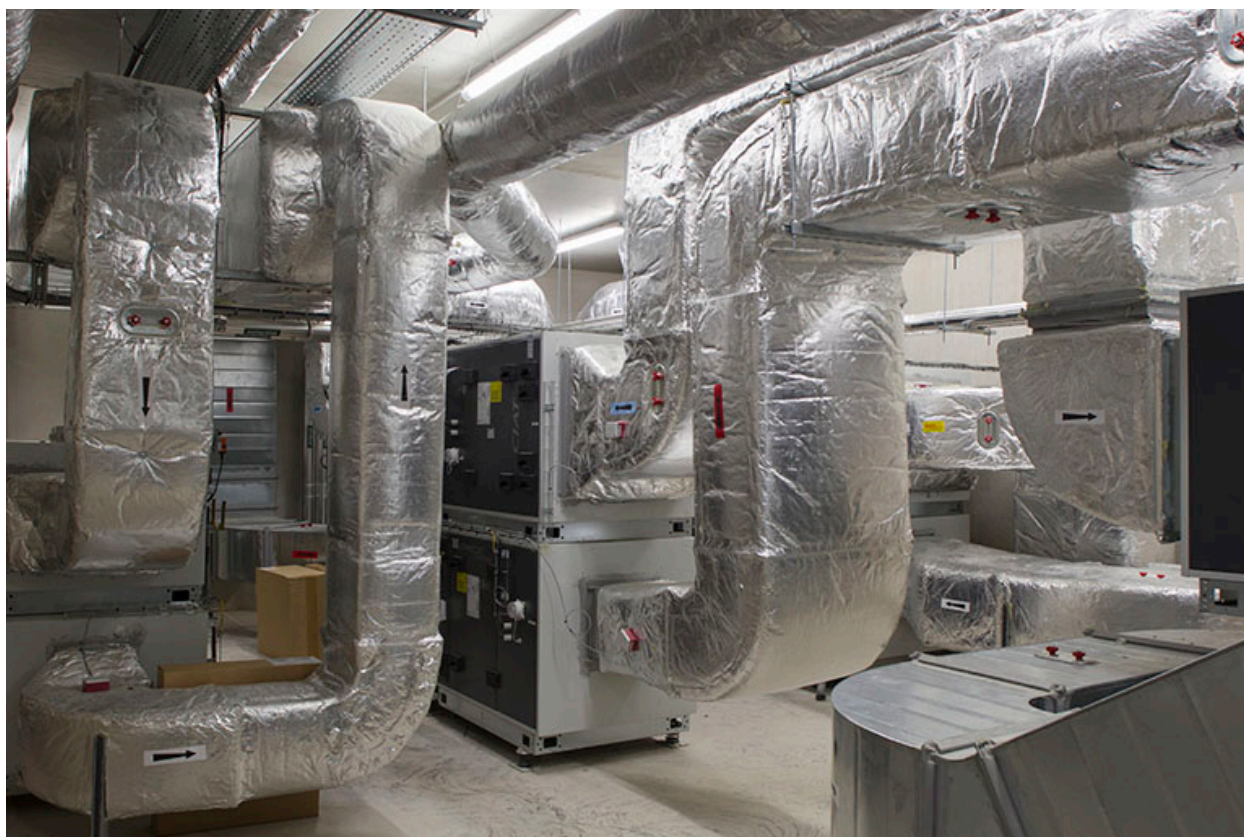
Machinerie d'extraction d'air du p le h telier.
