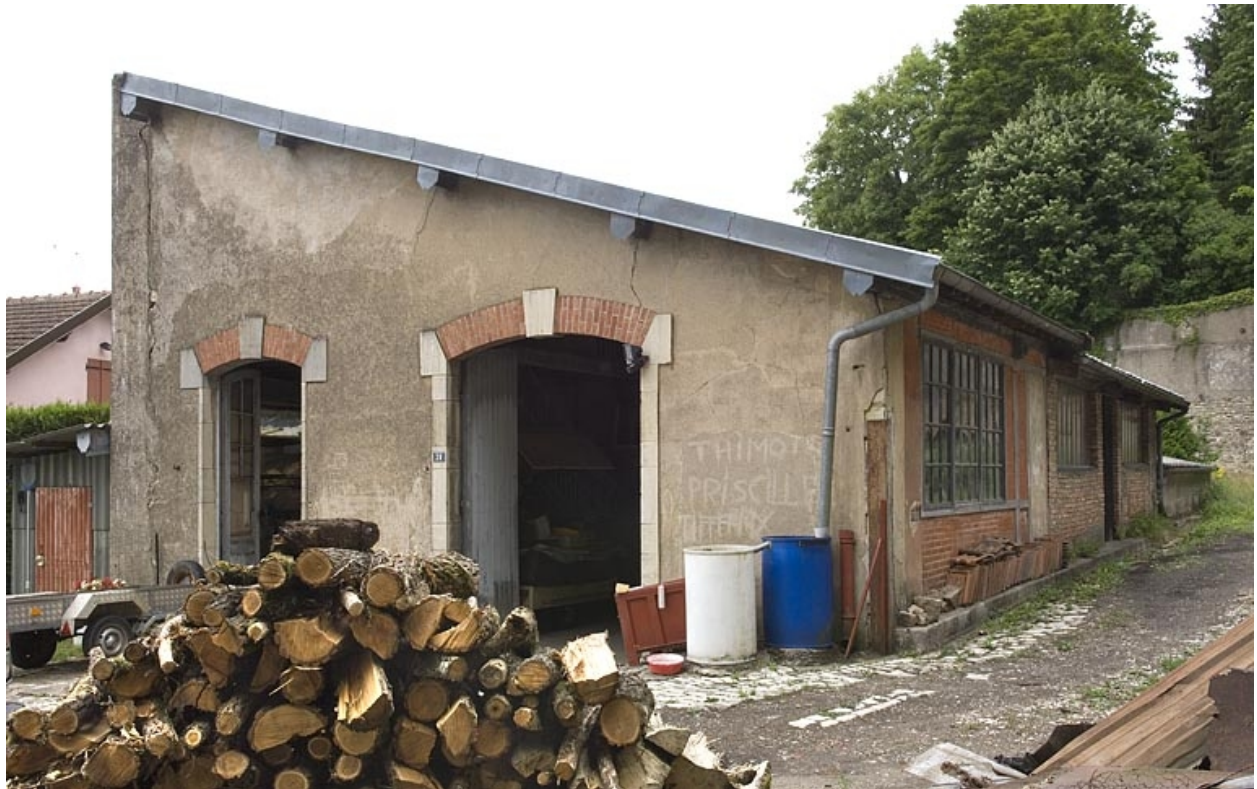
Vestige d'un atelier incendié.
