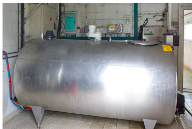
Tank à lait. Phot. Sonia Dourlot IVR43_20143900896NUC2A
