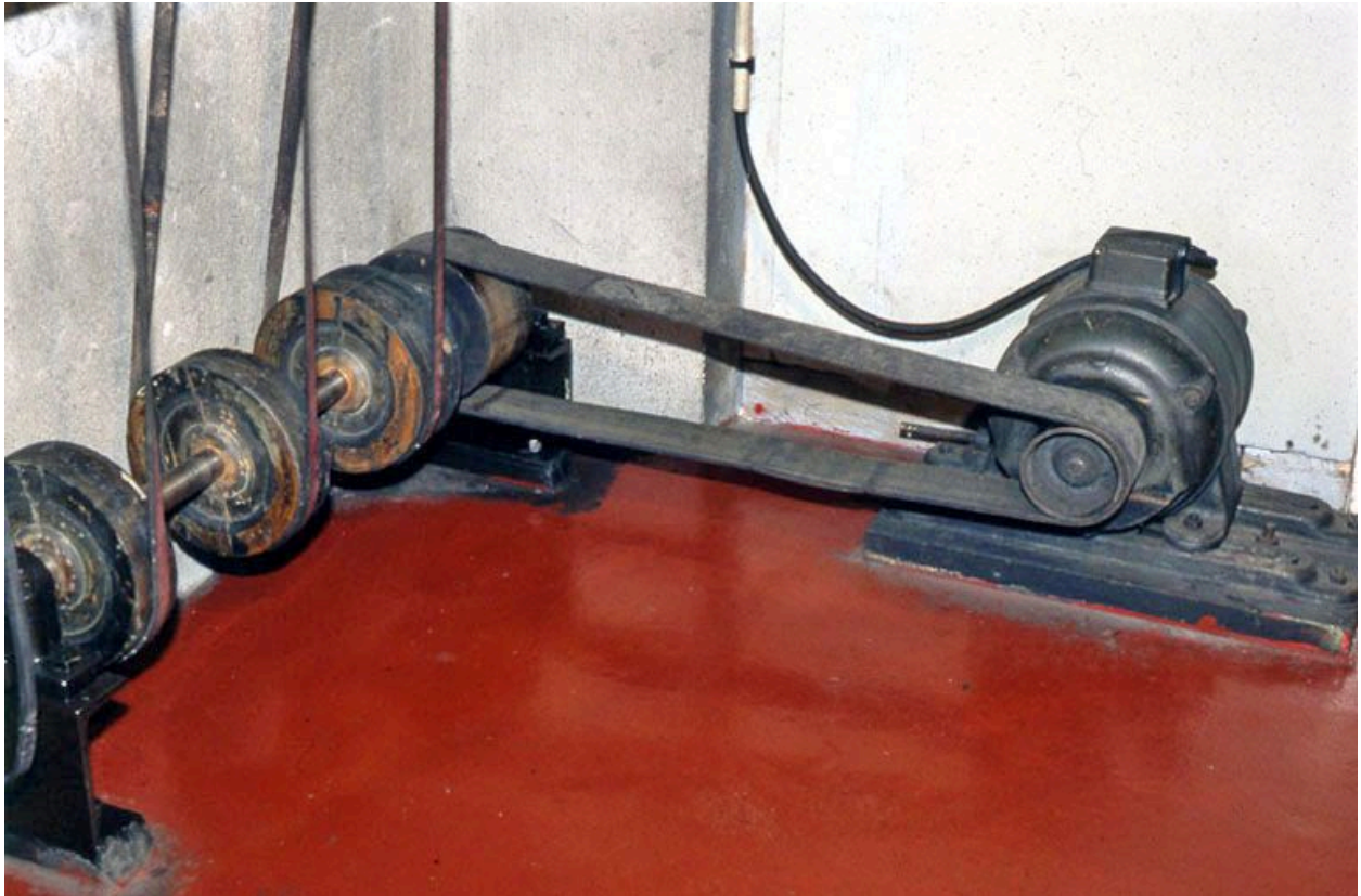
Moteur électrique Roulland et arbre de transmission.
