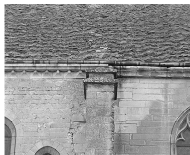
Elévation gauche : traces de collage entre les 4e et 5e travées de la nef. Phot. Jean-Luc Duthu IVR26_19955800411X
