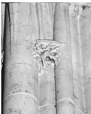
Collatéral droit, 3e travée, pilier postérieur gauche : détail du culot inférieur. Phot. Jean-Luc Duthu IVR26_19955800366X
